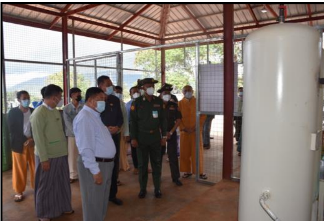
ကျေးသီးမြို့တွင် တည်ဆောက်ထားသော Oxygen Plant စက်ရုံအား ရှမ်းပြည်နယ်ဝန်ကြီးချုပ်နှင့်တိုင်းမှူးတို့က သွားရောက်စစ်ဆေးနေမှု
